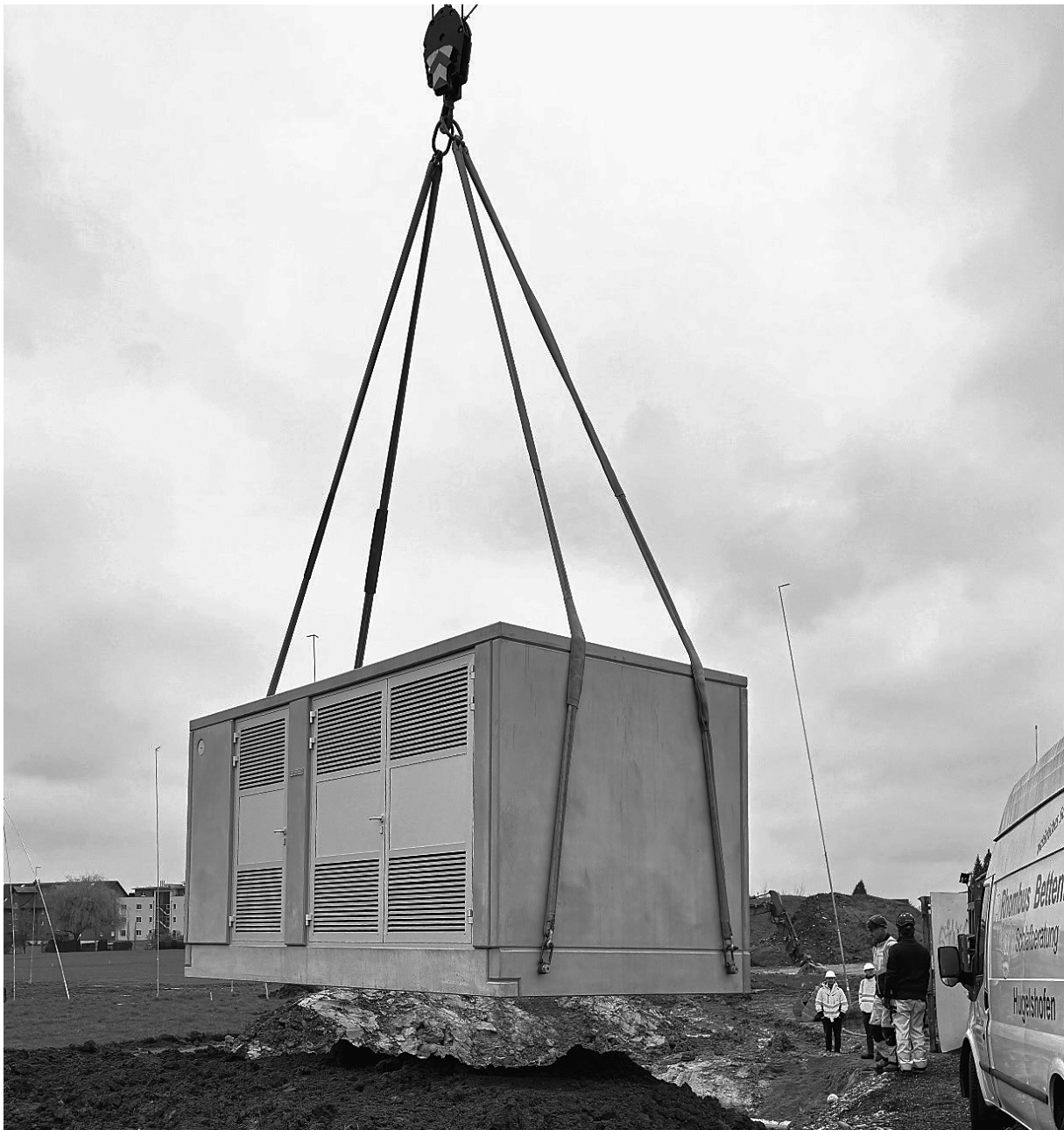
Transformatorstation Ziegeleiquartier, Berg
