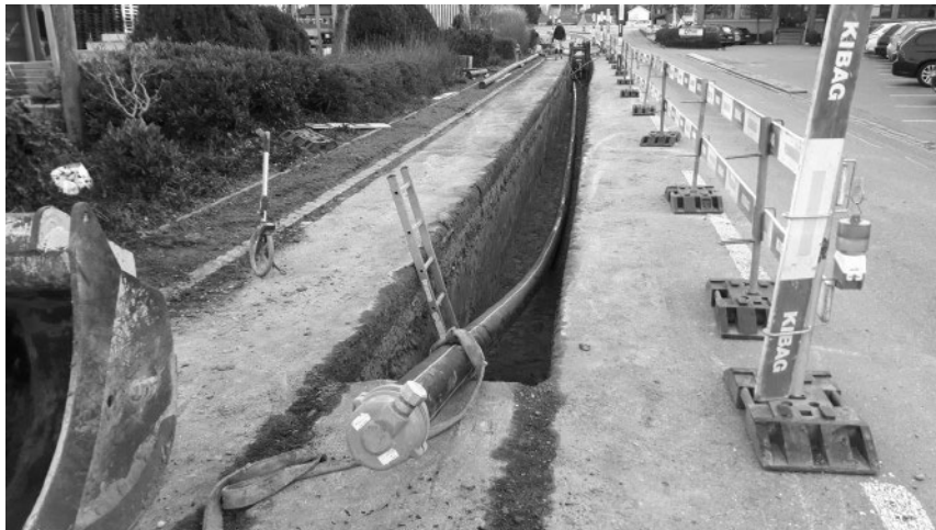
Baustelle für die Sanierung der Werkleitungen in der Weinfelderstrasse in Mauren im Frühjahr 2018.
